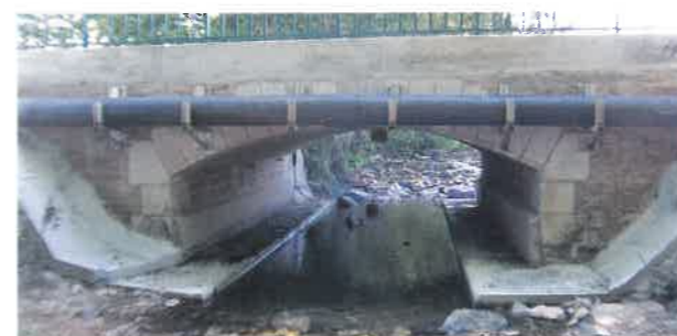
Échancrure réalisée dans le tablier béton sous le pont, rendant le seuil franchissable pour la faune et les sédiments (travaux réalisés par le conseil départemental de Saône-et-Loire)
